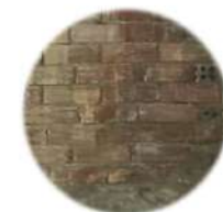
5. Φθορά στη τοιχοποιία με τούβλα στο πίσω δωμάτιο
